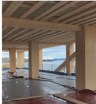
Fig. 80. Fotografía del forjado durante la construcción de la Torre Mjøstårnet, Noruega. Fuente: https://cutt.ly/fmyKyuc
