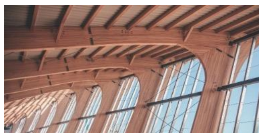
Fig. 75. Fotografía exterior de la estructura de GLT de frondosa en el Museo de Arte Contemporáneo Americano. Fuente: equipo de ingenieros estructurales en madera de Oak Ingeniería.
