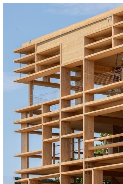
Fig. 69. Estructura del edificio OSH ( Our Shelves House ), Madrid. Fuente: Jesús Granada en https://n9.cl/getox
